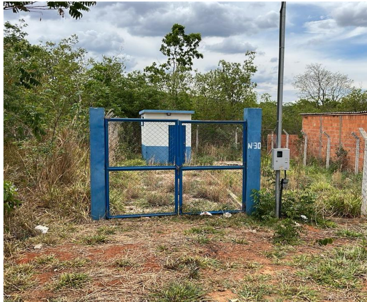
Figura 29: ETE 02 do Município de Claro dos Poções.
