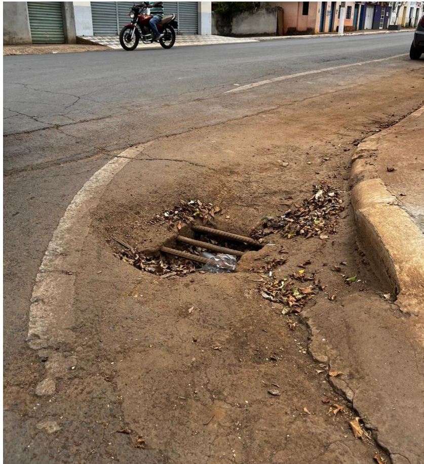
Figura 35: Boca de lobo. Fonte: CODANORTE,2025.
