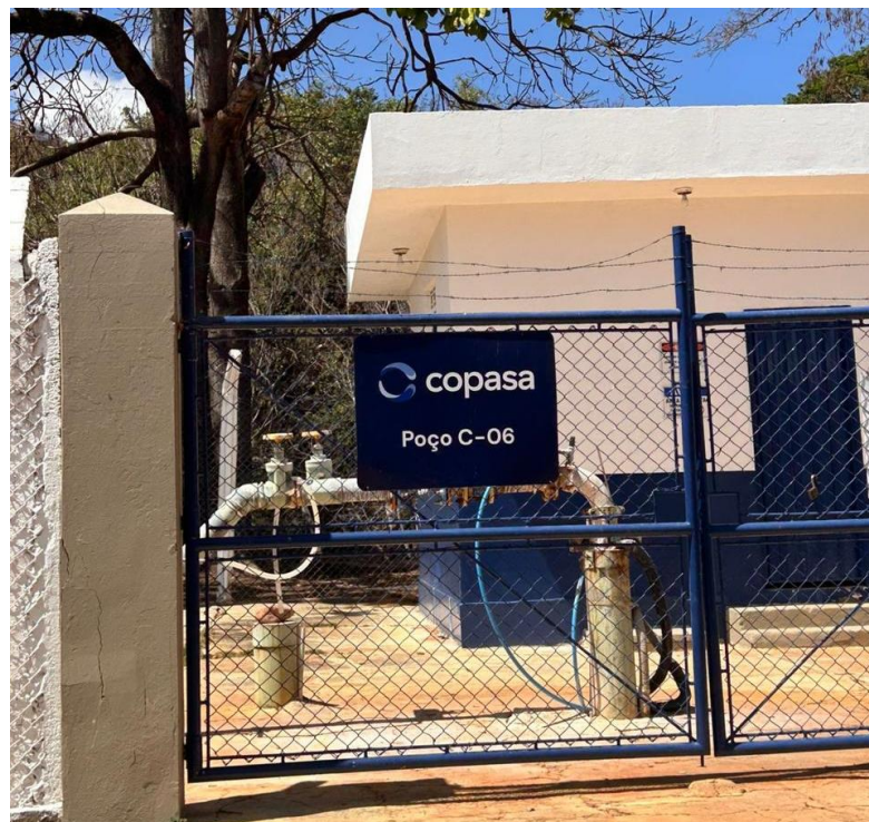
Figura 19: Poço de captação de água Fonte: CODANORTE,2025
