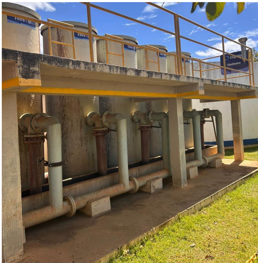
Figura 21: Filtros da Estação de Tratamento de Água. Fonte: CODANORTE,2025
